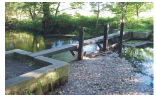
Vorhandene Wehranlage mit erkennbarer Materialermüdung
